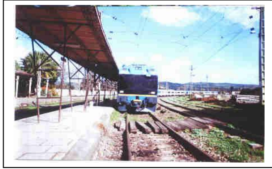
Paso peatonal en malas condiciones
